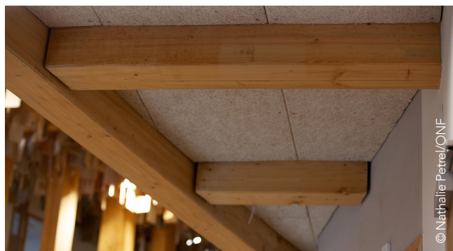
Lamelles de bois scolyté dans les poutres du siège de l'ONF à Maisons-Alfort
