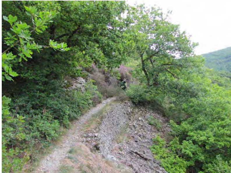
Photo 142 : banquette RTM en forêt domaniale de la Sioule (parcelle 12), soutenant encore en 2011 le « sentier du garde ».
